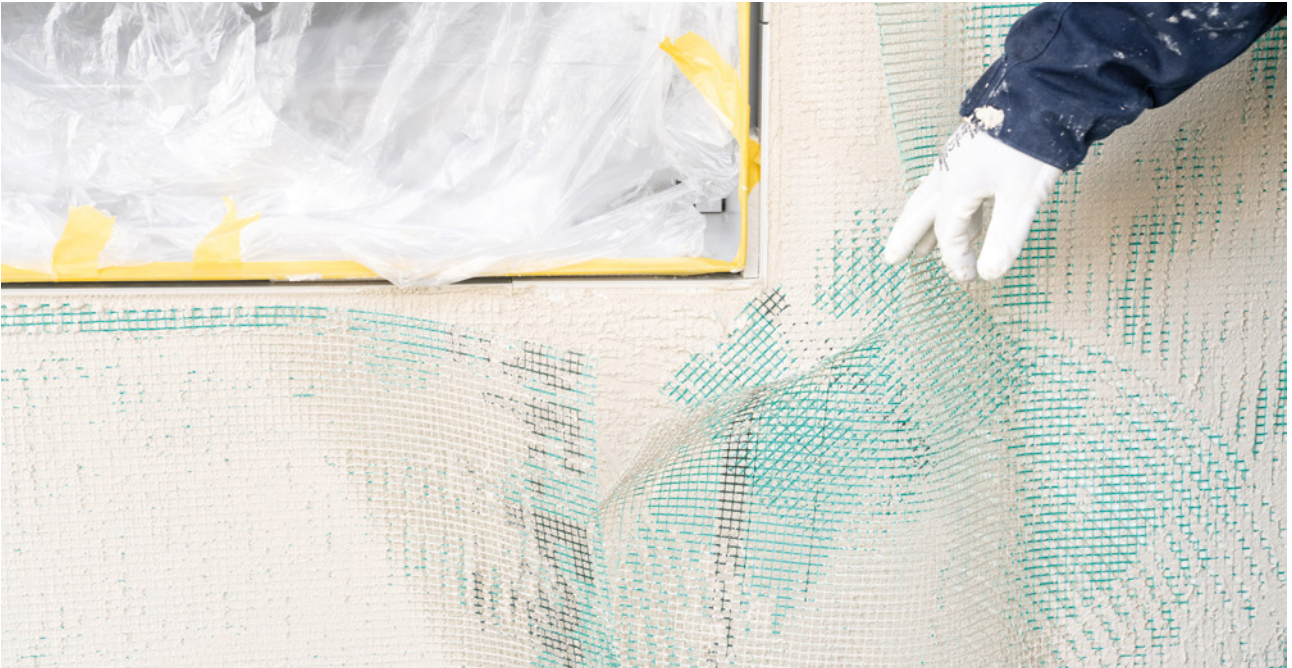
Nuovo isolamento termico esterno del complesso residenziale nel quartiere Sternmatt di Lucerna.
